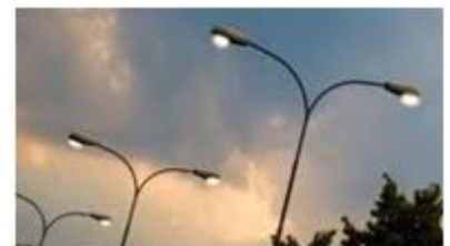
IMPIANTO DI PUBBLICA ILLUMINAZIONE
